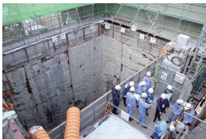
施工不良が分かった防潮堤の地中連続壁基礎＝2024年5月
